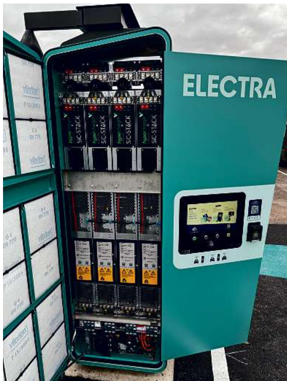
Bild 3 Alpitronic-Schnell-ladesäule mit vier Stacks.
