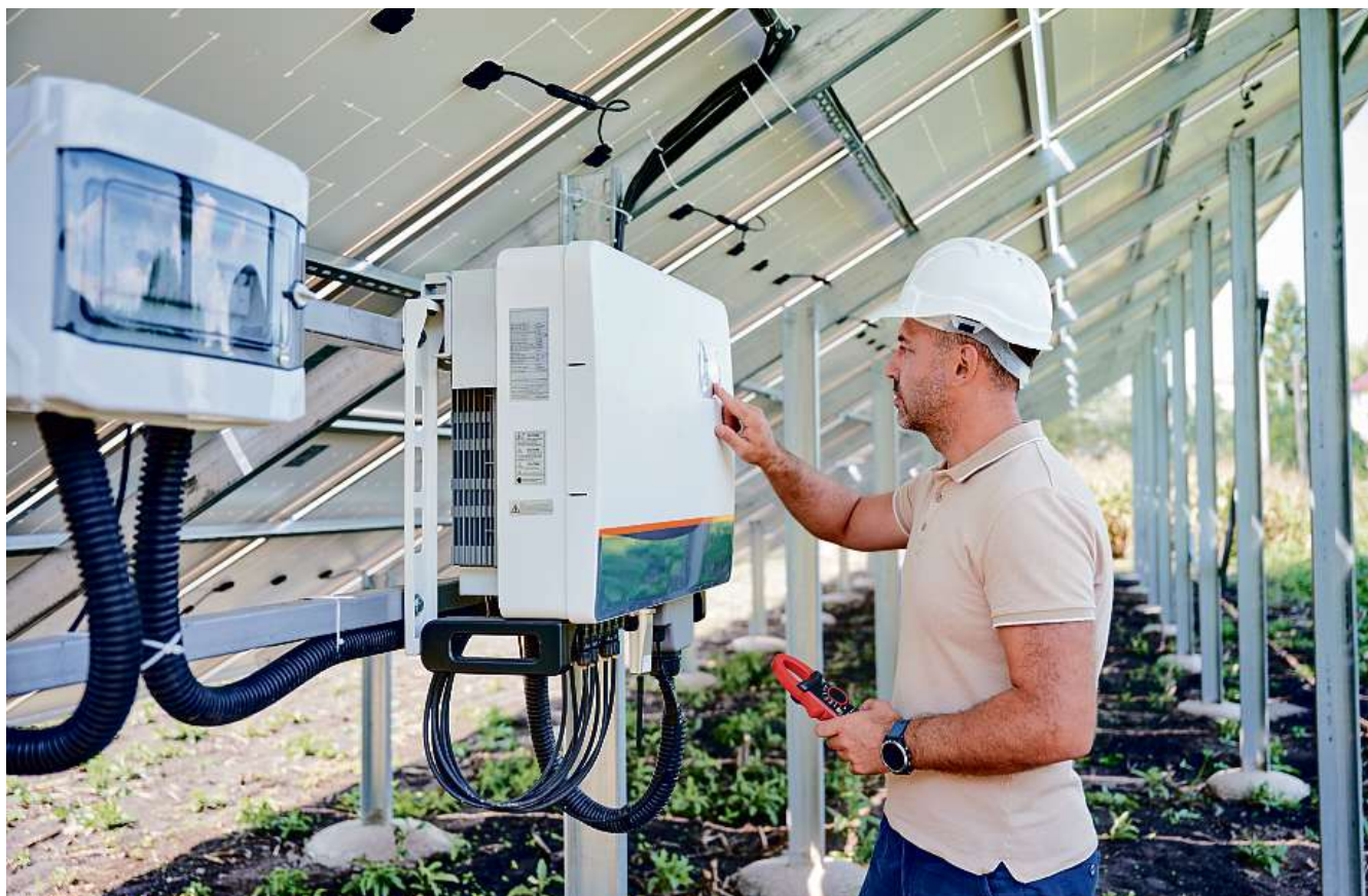
La protection RI de l'onduleur permet de déconnecter une installation PV du réseau en cas de besoin.
