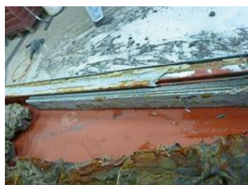
Asbest zwischen Brandschutztür und Schwelle.
