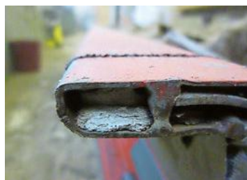
Asbest hinter Metallteilen einer älteren Brandschutztür.
