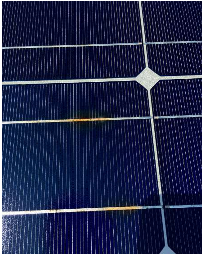
Hotspot mit durchgebranntem Backsheet.
