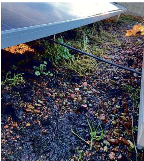
Stolperfallen – Leitungen auf Flachdächern sind nicht erlaubt.
