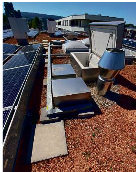
Generatoranschlusskasten unter verschraubtem Blech – schlechter Zugang.
