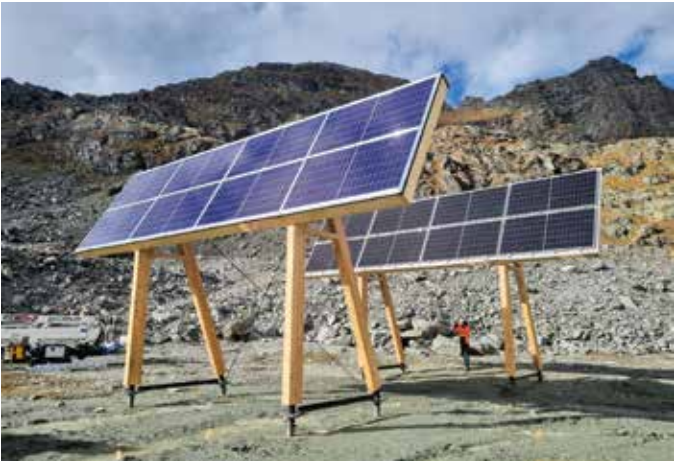
Test de tables solaires en bois local sur le site de Prafleuri solaire (COMMUNE D'HÉRÉMENTE)
